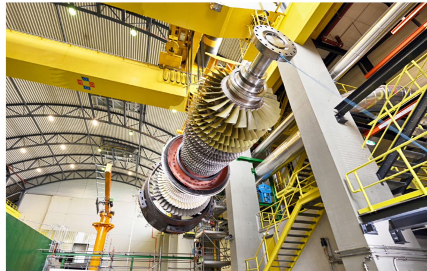
Weit verbreitet: Von der SGT5-4000F, mit der die Versuchsreihe im Kraftwerk Donaustadt erfolgte, sind weltweit etwa 360 Stück im Einsatz
